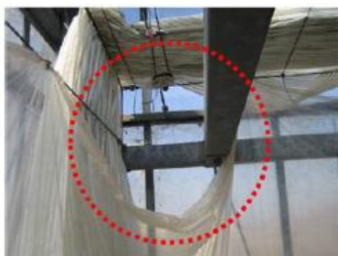
温室のコーナー部の隙間
