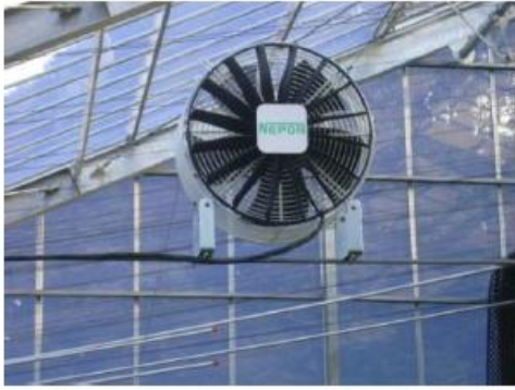
空気の流れをつくる循環扇
