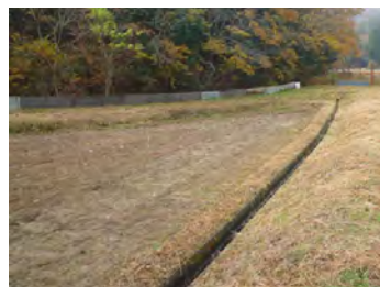
事故現場(1.2mの法面) ※一見してなだらかな傾斜であっても、 転落・転倒による死亡事故につながる危険がある
