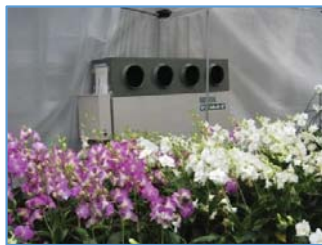
安定的採熱とヒートポンプ利活用
